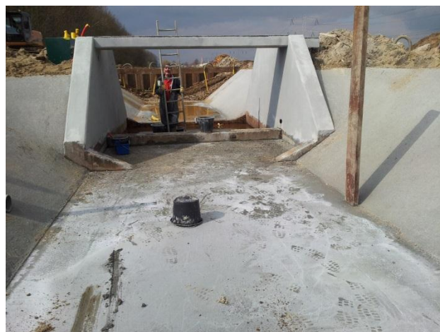
Een van de gerenoveerde en geautomatiseerde stuwen in de Raam
