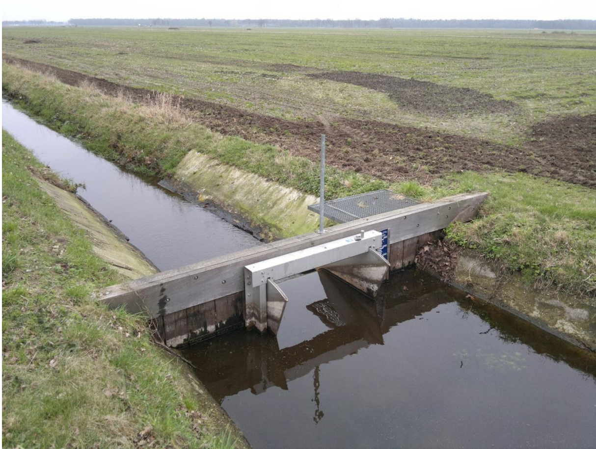
Figuur 1: Stuw in houten constructie
