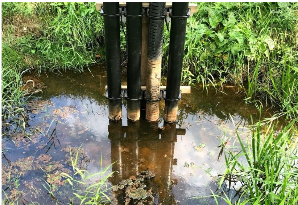
Figuur 3: Sensoren geplaatst in geperforeerde buizen in de Vinkenloop.
