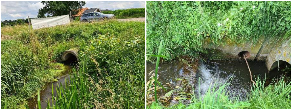
Figuur 10.1 Foto links, betonnen duiker vanaf benedenstroomse zijde gezien. Foto rechts, stuw 112A5 en betonnen duiker vanaf bovenstroomse zijde gezien.
