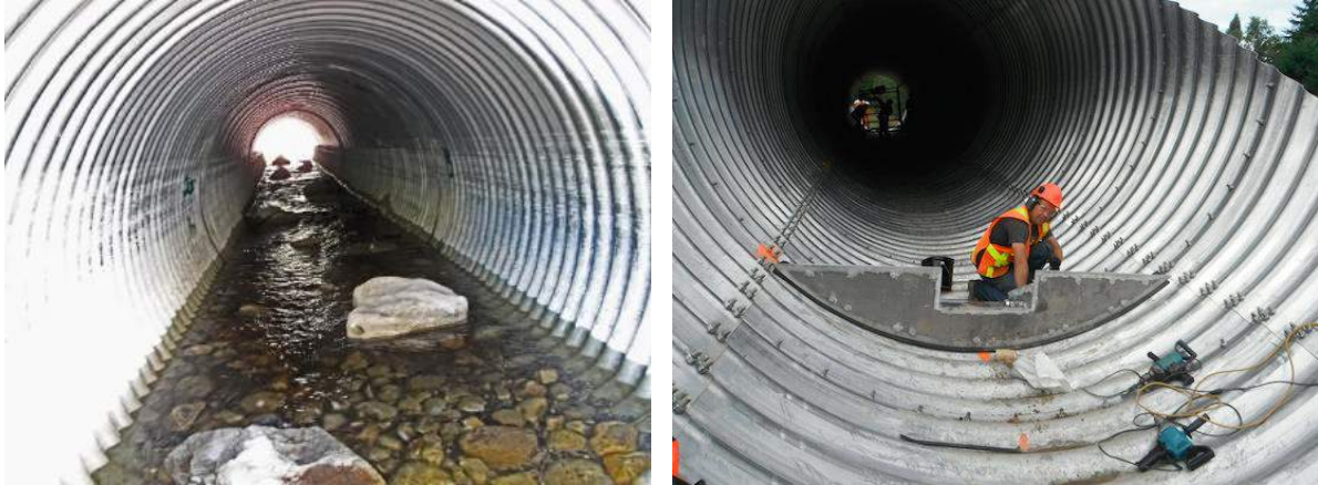
Figuur 8.2. Voorbeelden van inpassing van overlagen in de duiker (rechts) en stoorstenen met stenen bedding in duiker (links).
